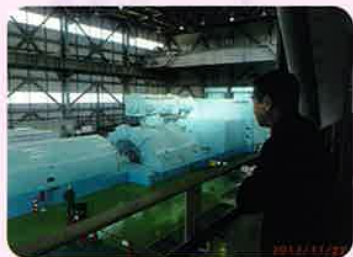
11月22日 東北電力仙台火力発電所 ガスタービン
