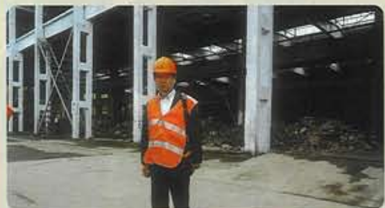
6月9日 ウラジオストク・ソラース物産 トヨタ・ランクルのKD工場建設中
